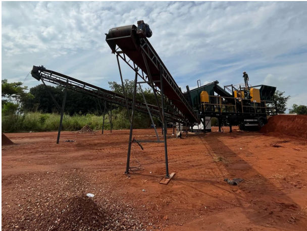
Usina de reciclagem de resíduos da construção civil emprestada ao município pelo Codevar.
