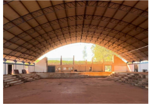
Jaborandi ganha mais um espaço esportivo com as obras do Ginásio de Esportes, que estão a todo vapor.
