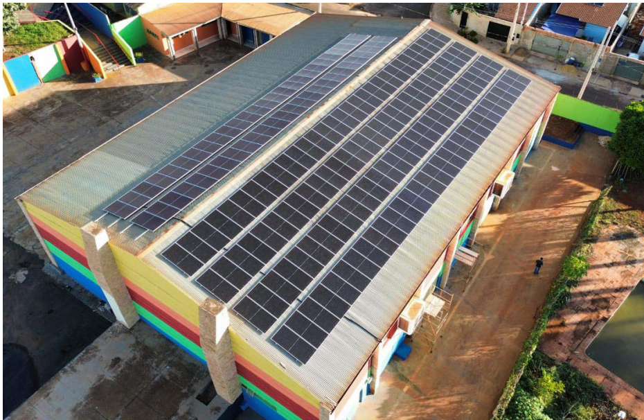
Placas instaladas na Escola Olinto, mais um prédio público beneficiado com a energia solar.
