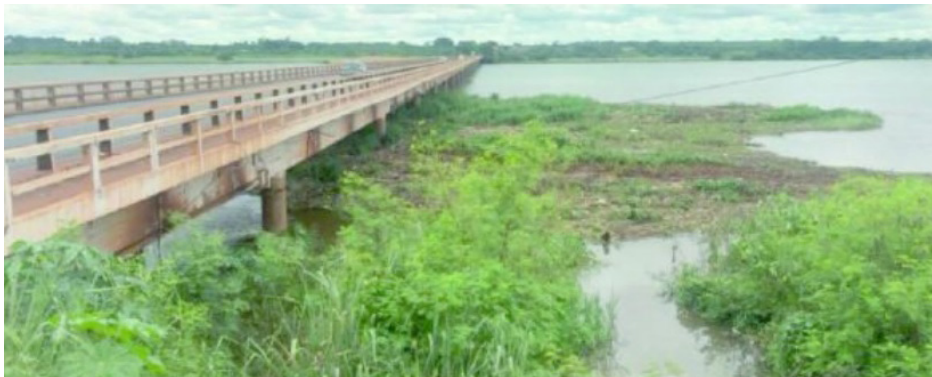
Ilhas de vegetação enormes que se acumulam embaixo e nas laterais da Ponte Gumercindo Penteado.
