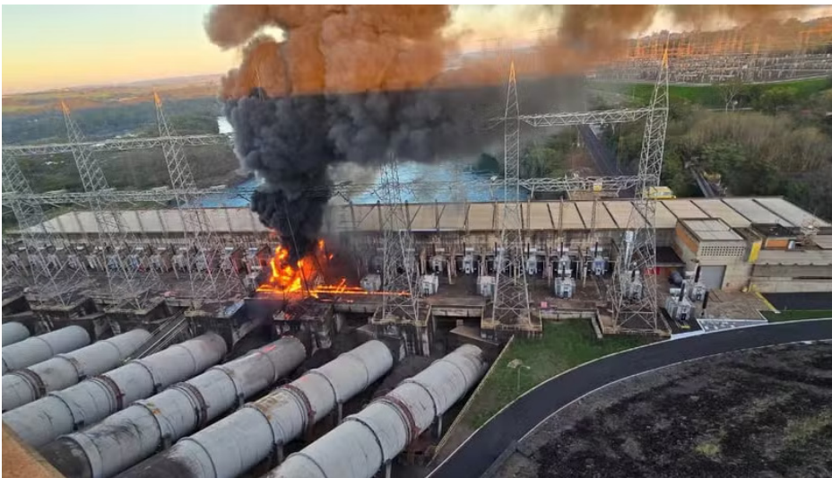
Área das turbinas atingida pelo fogo.
