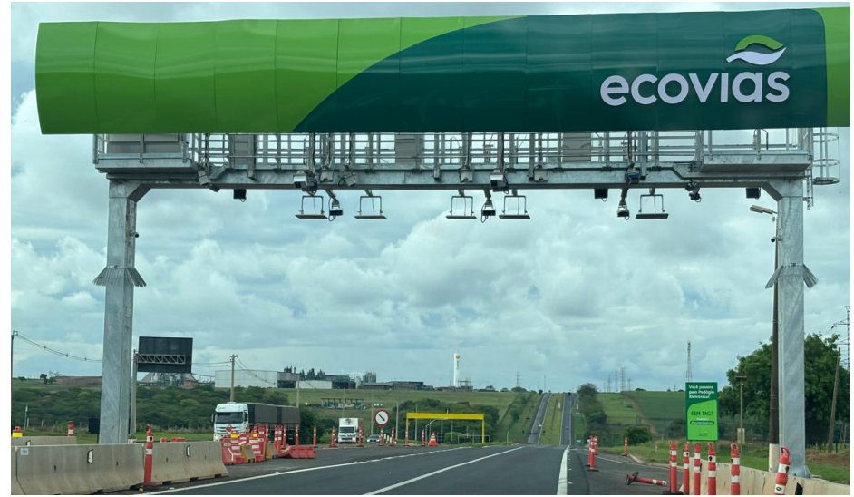
Pórtico instalado na Rodovia Faria Lima, em Colina, que entra em operação em breve.
