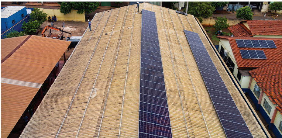
Imagem aérea do sistema de energia fotovoltaica que abastecerá o setor educacional.
